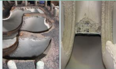
Pitting en slijtage was duidelijk
